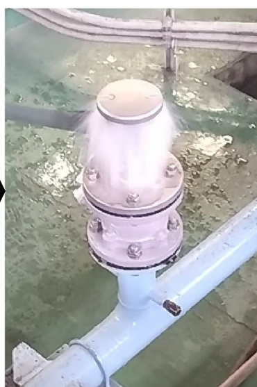
補修弁を急激に全開 多量排気の後、瞬間的に水が噴出する。 (初期漏水現象)
