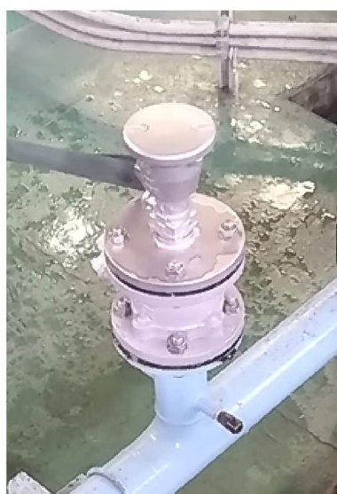
補修弁全閉 空気弁内部は空気のみ
